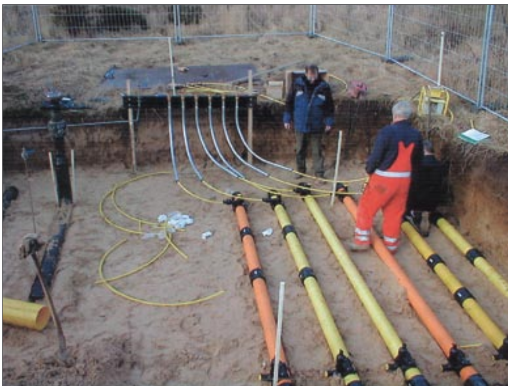
Billedet viser nedlægning af forsøgsrør. De to sorte rør til venstre er 19 bar ståldistributionsrør. Resten er nye og brugte rør fra det danske og svenske gasnet.
