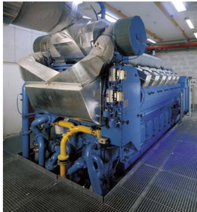
Gasmotor i Tørring, 5.1 MW e
