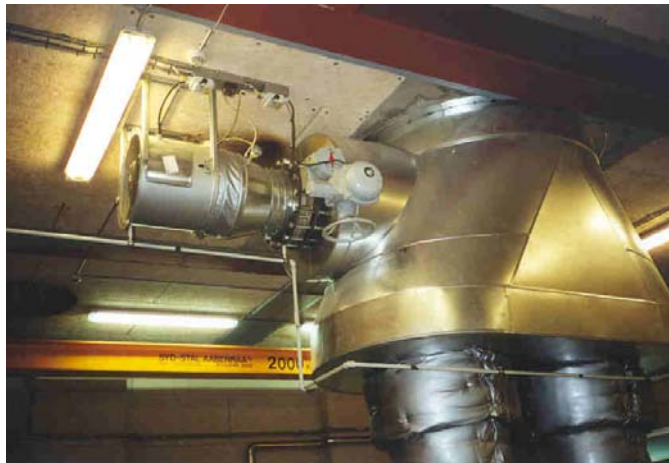
Ventilator til skylning af udstødssystem
