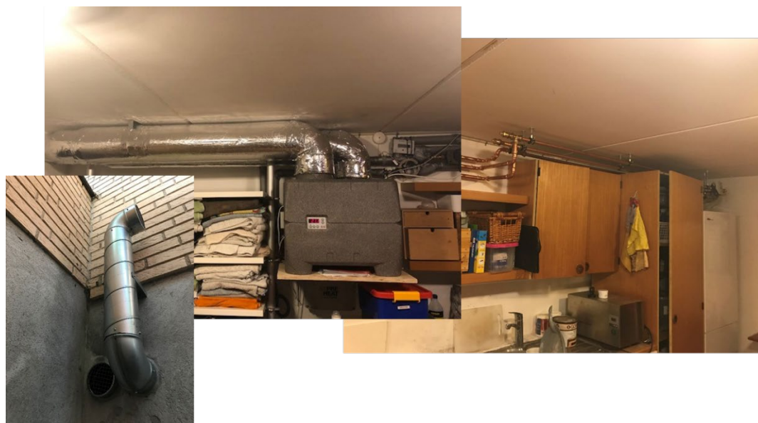
Figur 6 Foto af eftermonteret luft/vand varmepumpe (inkl. udeluftkanaler) på gaskedelinstallation i Kokkedal.
