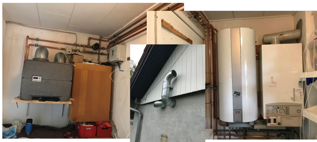
Figur 7 Foto af eftermonteret luft/vand varmepumpe (inkl. udeluftkanaler og styrboks) på gaskedelinstallation i Allerød.
