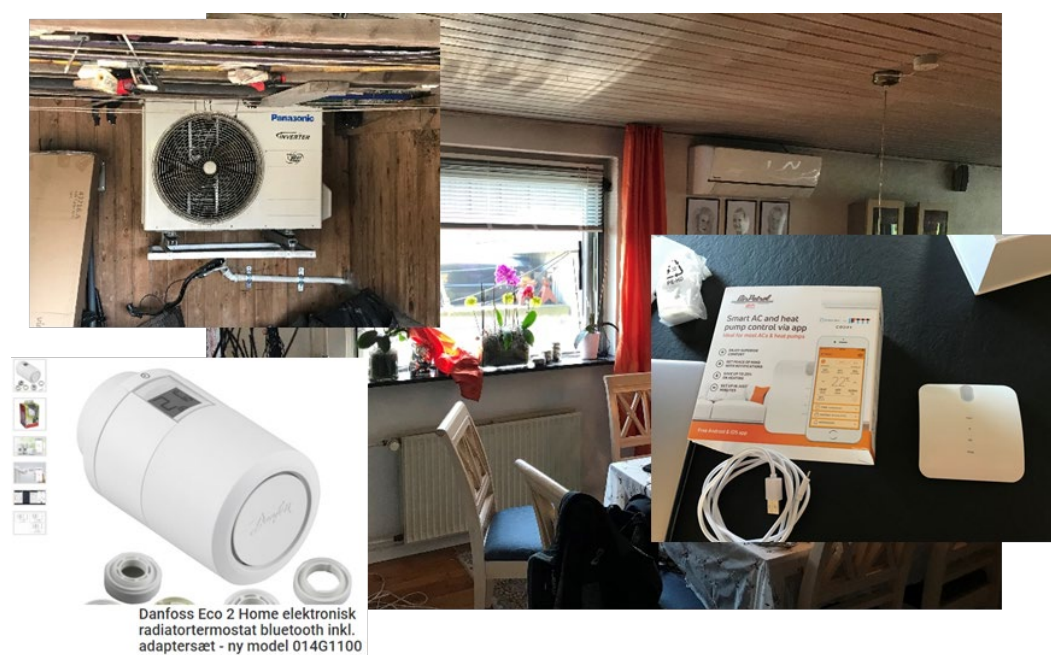
Figur 9 Foto af gaskedelbaseret radiatorinstallation i Nyrup med luft/luft-varmepumpe (inkl. AirPatrol styreenhed og termostatventil).
