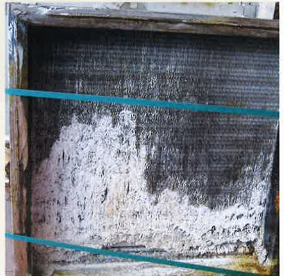
Kraftigt korroderet veksler (economizer) set fra røgens indgangsside.
