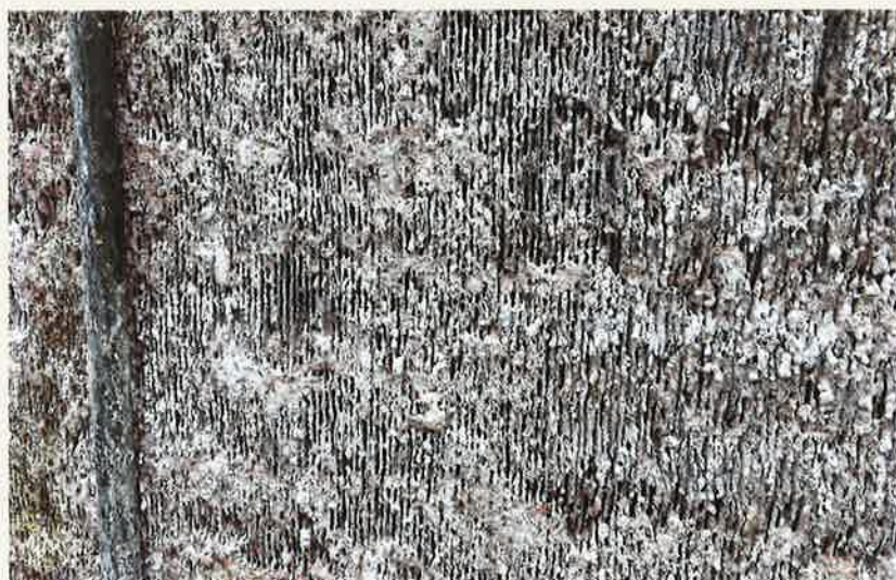
Nærbillede af korrosions-/forvitningsområde på røgens indgangsside.
