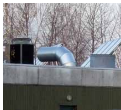
Figur 1: Placering af Robur E3 gasvarmepumpe og solfangere på Avedøre Stadion
