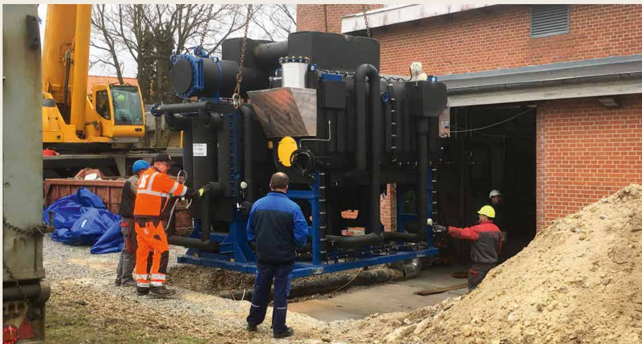
Varmepumpen ankommer til værket i Klokkeholm cirka fire kilometer fra solvarme- og halmfyringsanlæggene.
