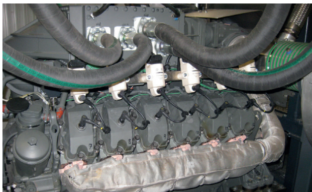
Gasmotoren til varmepumpen
