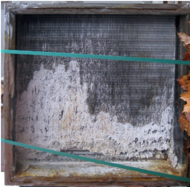
Tæring/forvitring på røggaskølerens indgangsside
